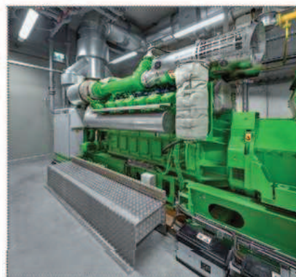
Ein neues BHKW dient zur Erzeugung von Strom, Wärme und Dampf sowie zur Warmwasseraufbereitung für die Pasteurisierung.
