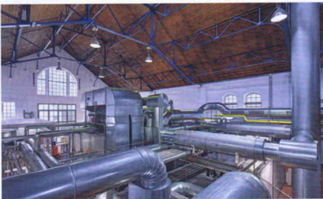
Abb. 2: Zwei BHKWs decken die gesamte Grundlast des Klinikums ab und bilden das neue Herz der Energiezentrale im denkmalgeschützten Kesselhaus (Quelle: Gammel Engineering GmbH)
