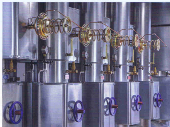
Abb. 5 und 6: Im Zug der Modernisierung der Erzeugung und Wärmeverteilung wurde auch die MSR-Technik grundlegend überarbeitet
