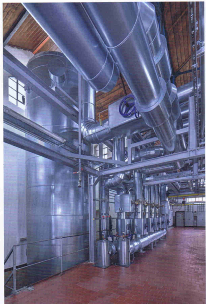
Abb. 3: Als Ausgleich bei Lastspitzen wird nun zusätzlich ein Pufferspeicher mit 50 m 3 Fassungsvermögen eingesetzt (Quelle: Gammel Engineering GmbH)
